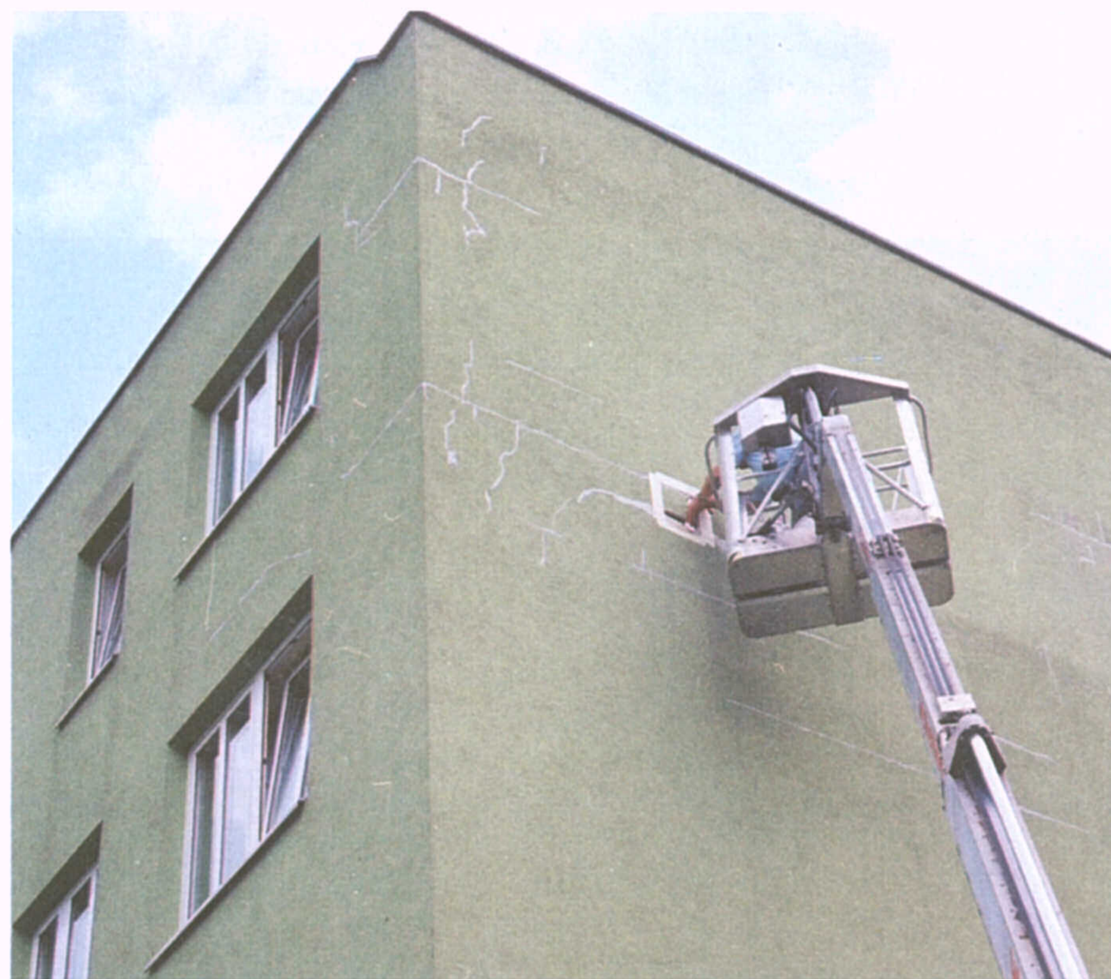
Gerissene Fassaden mit Dichtstoffen (Kitt) gegen eindringende Feuchtigkeit abzusichern ist hinausgeworfenes Geld.
