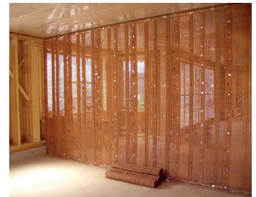
Stabile Innenwände mit hohem Schallschutz
